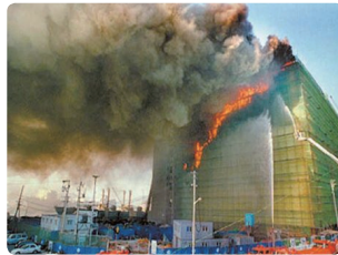
부산 냉동창고 신축공사 화재 ('98. 10. 29 사망27, 부상16)
