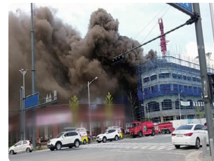
근린생활시설 신축공사 화재 ('16. 9. 10 사망4, 부상2)
