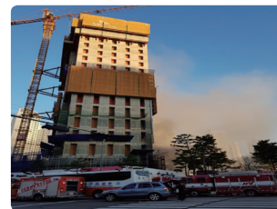
광교○○ 신축공사 중 화재 ('17. 12. 25 사망1, 부상 13)
